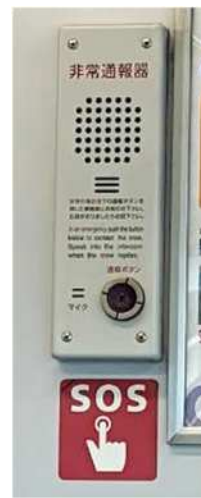
車内非常通報装置
